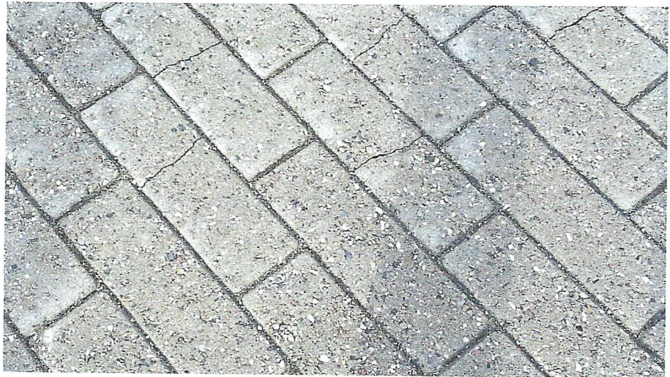
Figur 4. Knækkede belægningssten på stamvejens nordligste hævede flade.
