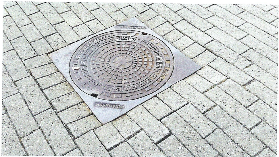
Figur 5. Eksempel på niveauforskel mellem brønddæksel og belægning. Belægningsstenene ligger skråt og løst. Der mangler fugemateriale.
